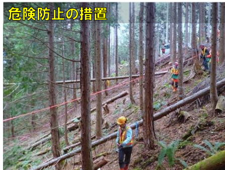
困難木を直ちに処理できないときは、危険区域の表示を行う
