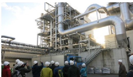
真庭木質バイオマス発電所の視察
