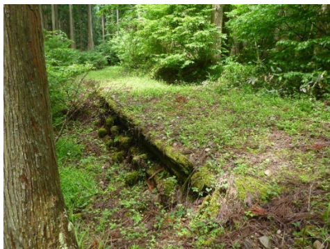
既設作業道の木製土留工腐朽状況
