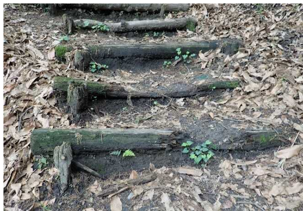
（写真4：腐朽が進行する丸太階段）
