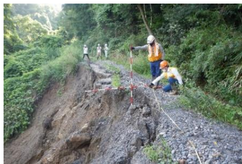
被災した民有林林道の調査
