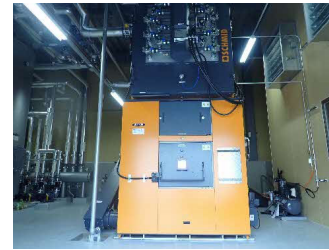
（木質チップボイラー）
