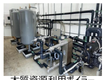
木質資源利用ボイラー
