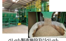
ペレット製造施設及びペレット
