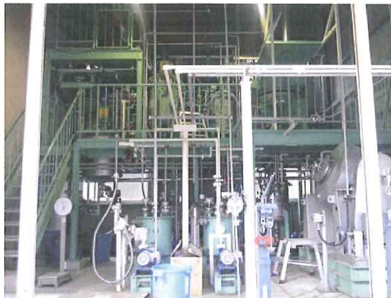
写真2 LP製造プラント各設備
