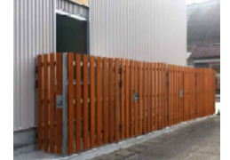
四国森林管理局 嶺北森林管理署外壁フェンス
