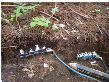
設置状況(近景)
