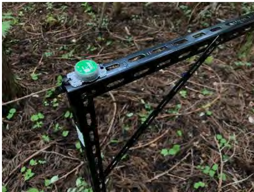
照度計設置状況近景
