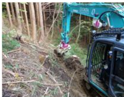
フェラーバンチャー付きグラップルバケットによる路網開設
