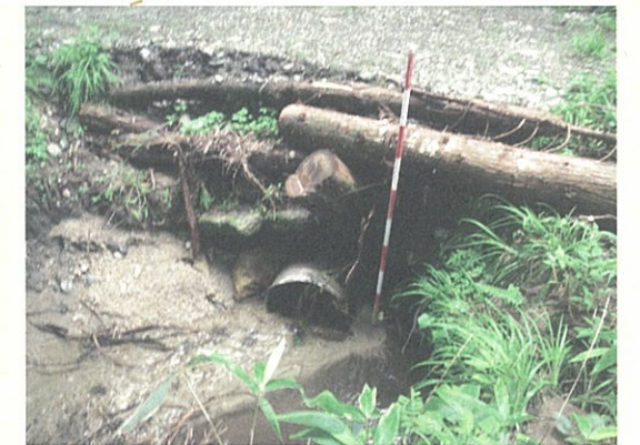
路面付近まで増水したが、路盤は損傷しなかった。
