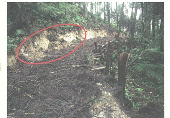
低めに抑えた法高により、崩落も最小限で済んだ。
