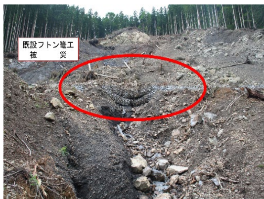
写真 14 台風による施設被災 （平成 21 年撮影）
