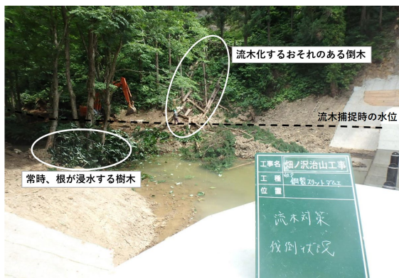
写真－６ 危険木等処理前の状況
