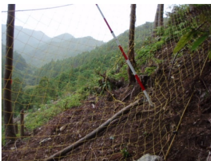
写真-2 シカによる噛切被害
