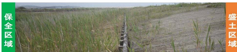
(写真-5) 法面への植生侵入状況
