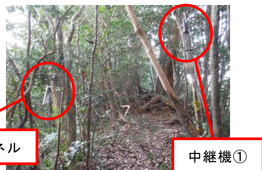
写真9：中継機①設置状況
