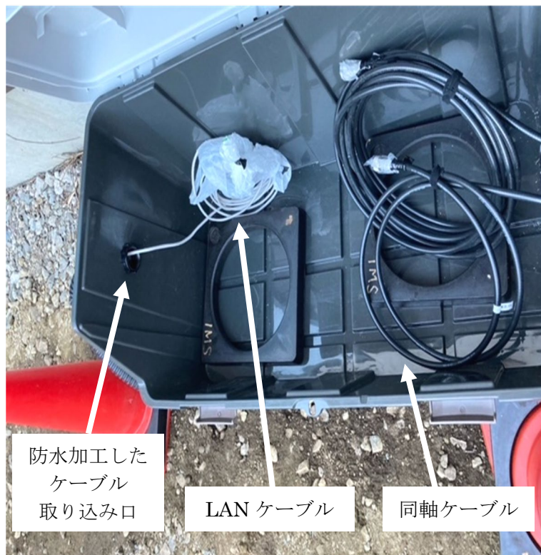
図 17 防水加工した収納ケースのケーブル取り込み口
