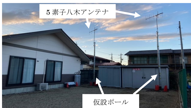
図 15 基地局側のアンテナ設置後の外観
