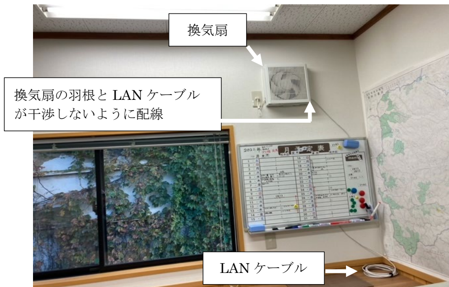
図 2.21 森林事務所の屋内への LAN ケーブル引き込み結果の外観
