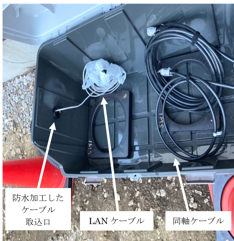
図 2.20 防水加工した収納ケースのケーブル取込口
