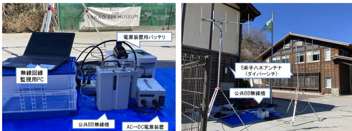
(a) 機器の設置風景 (高尾森林ふれあい推進センター)
