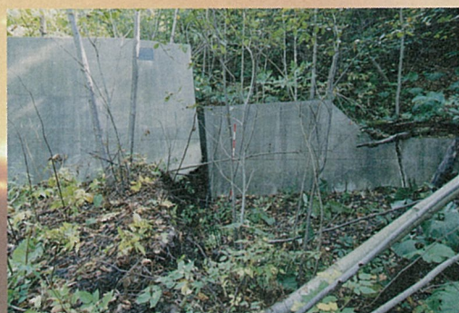
西山川支溪の治山ダムは地表変動に伴い変形した
