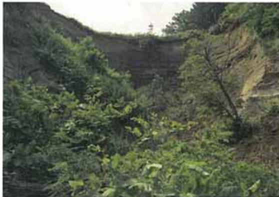
1976年 河岸崩壊地全景
