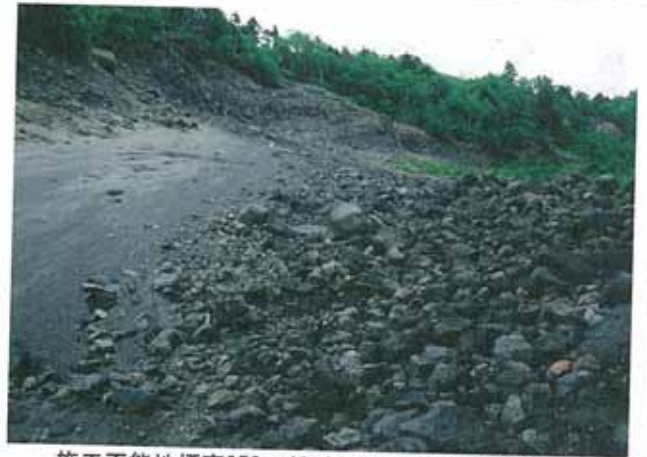
施工不能地標高950m付近の大崩壊地（2006. 8）
