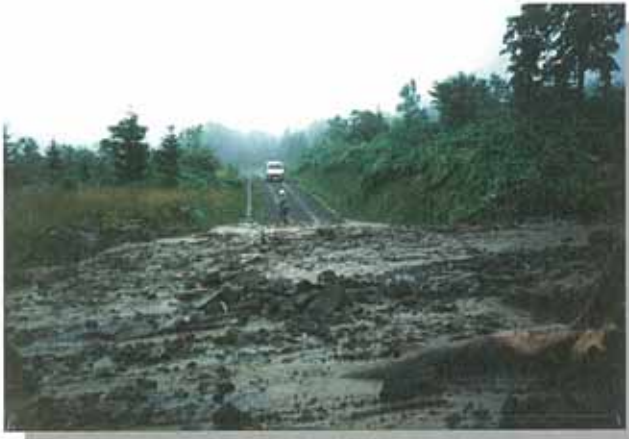
写真3-1 「学校の沢」中流域の土石流被害 (S56.8)
