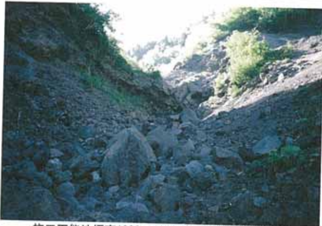
施工不能地標高1000m付近の溶岩崩落（2006. 8）
