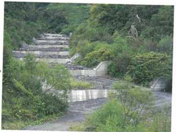
同左地点付近H元. No28号上流の状況（2006. 9）
