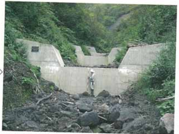
同左地点付近H13. No38号の状況（2006. 9）
