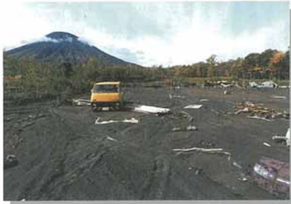
写真3-3 「墓地の沢」下流では工事機材・資材が被災した (S56.8)
