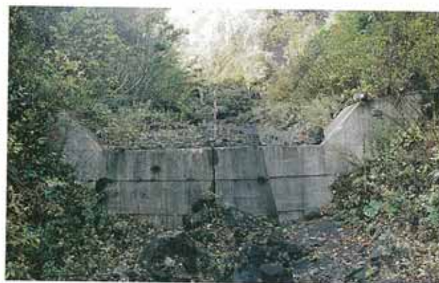
同左地点付近S55. No11号の現況（2006. 9）
