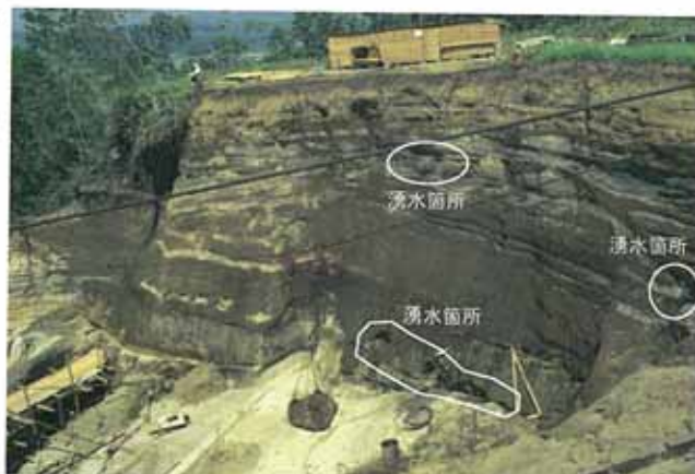
写真5-13 巽地区の崩壊地で確認された湧水 (S46.8) 「倶知安林務署施工箇所」
