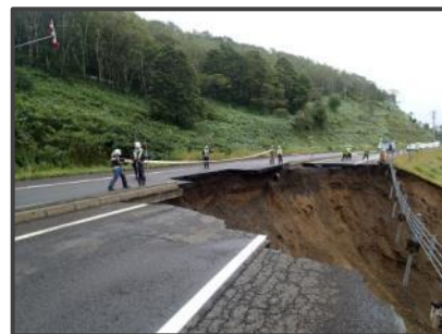
狩勝峠被災地
