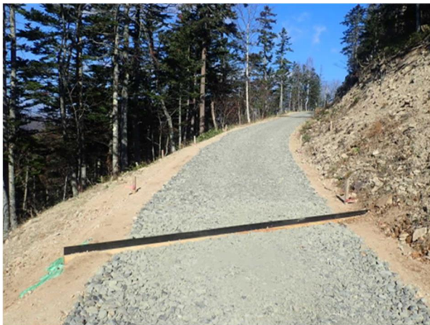
木製路面排水工
