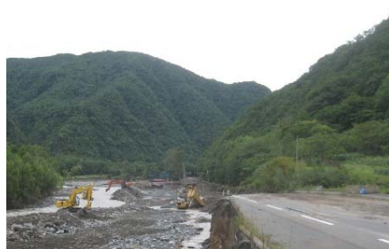
国道274号の決壊箇所 (平成28年9月撮影)
