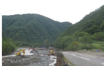
国道274号の決壊箇所 (平成28年9月撮影)
