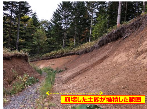
写真1 幅員が減少した林業専用道
