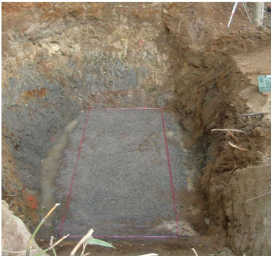
② 床掘完了後、基礎工（敷砂利）を実施 ※ 地盤が安定していない箇所においては、水平処理が容易である。
