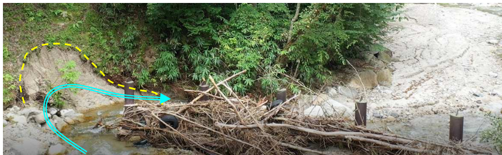
写真 5.2.1. 流木捕捉による溢流と溪岸侵食発生事例
