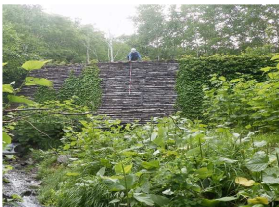
硫黄沢左支流 74 コンクリート堰堤 未満砂高:4.2m
