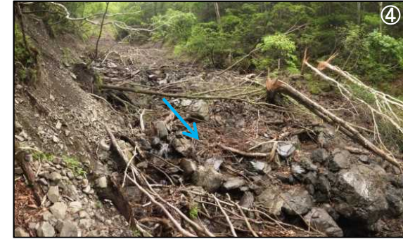
【上流荒廃状況】
