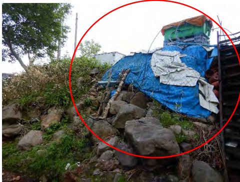
排水混入状況
