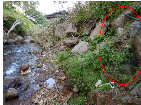
排水混入状況
