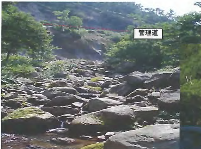
上流部の管理道と法脚浸食状況
