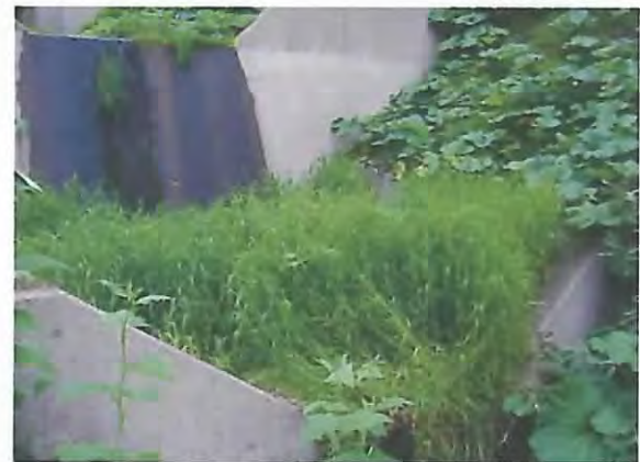
上流のコンクリート叩の状況。土砂が溜り草が生えている。
