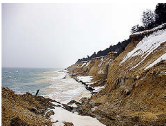
○施工前（波による浸食状況）
