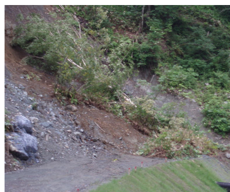
写真－1 地すべり性の斜面崩壊
