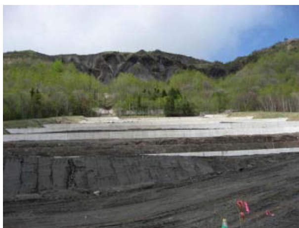
土砂災害を防止する治山ダム
