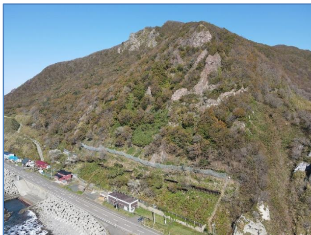
かもえない 落石などを防止する落石防護柵（神恵内地区）
