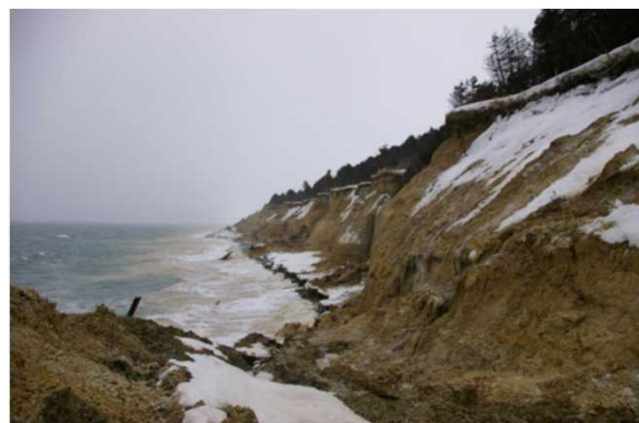
(崩落地：施工前)
