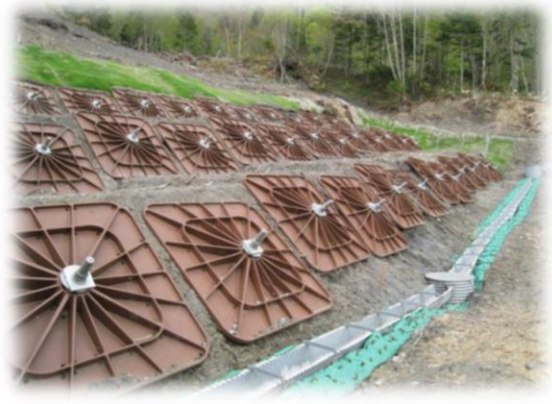
地すべり地の復旧(占冠)
