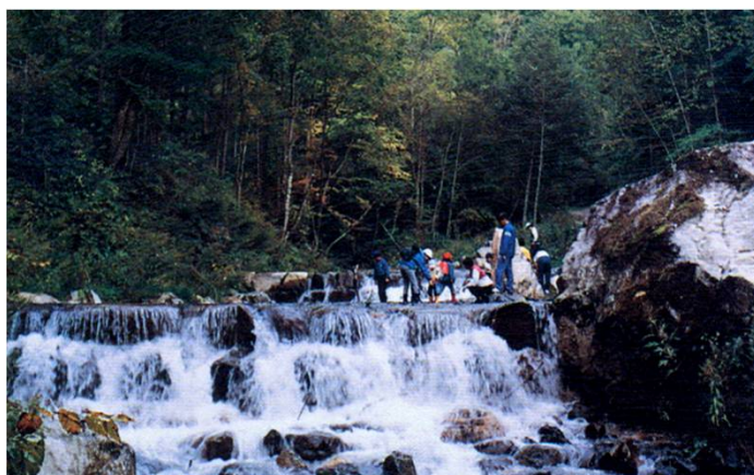
天然石を利用した床固工ダム (288林班サンゴの沢)
