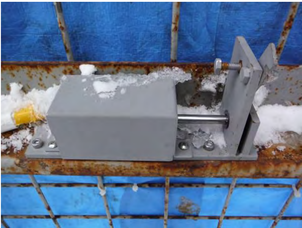
写真 8. 鋼製落とし扉の外枠(下半分の二重部)上部に取り付けたトリガー部分(扉閉鎖時).
