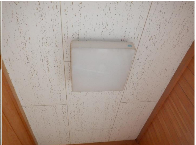
事務所玄関灯
