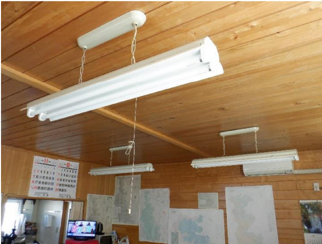
事務所事務室灯
