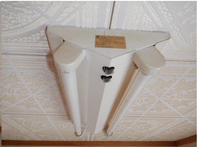
事務所玄関灯
