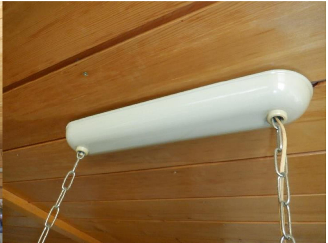
事務所事務室灯
