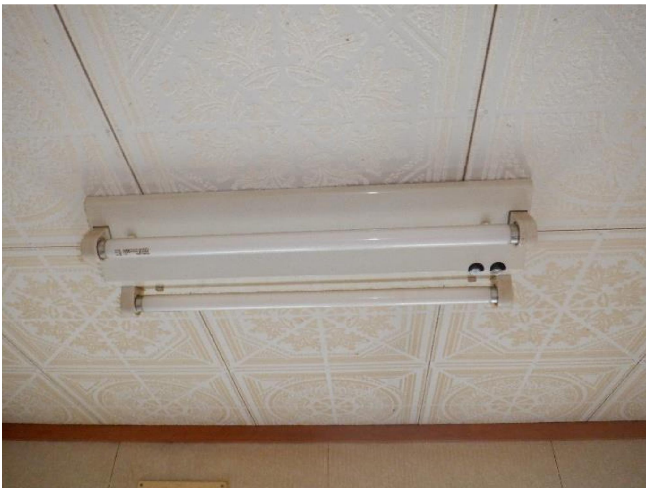
事務所給湯室灯
