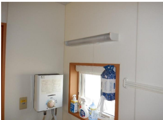
事務室湯沸所灯
