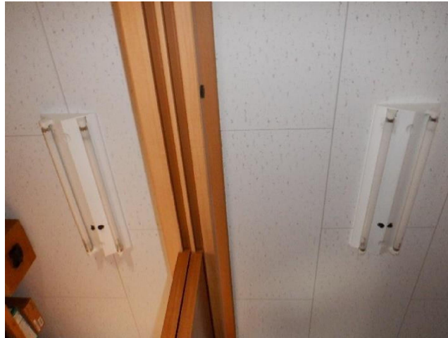
事務所男女トイレ前室灯
