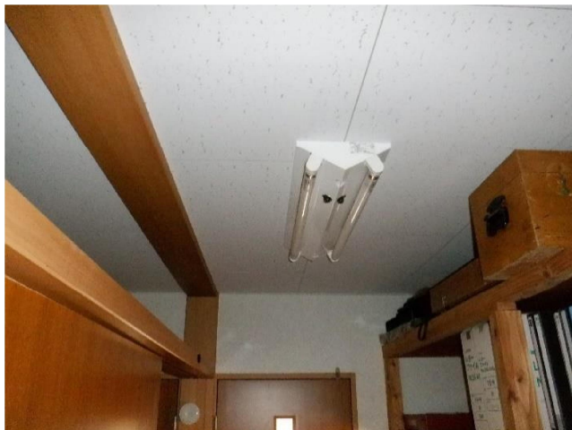
事務所女子トイレ前室灯
