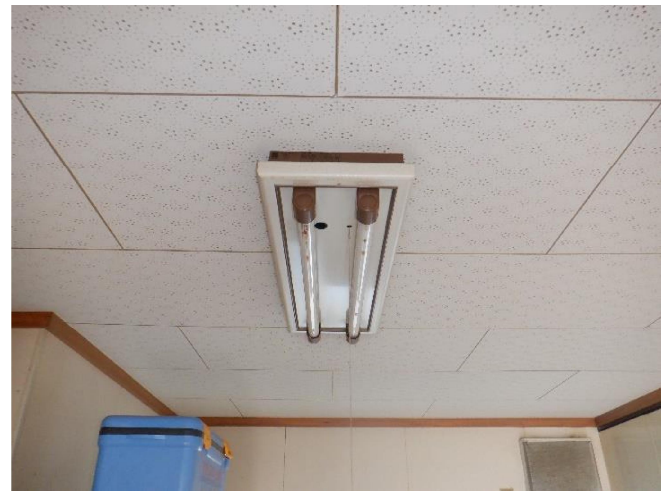
休憩所給湯室灯
