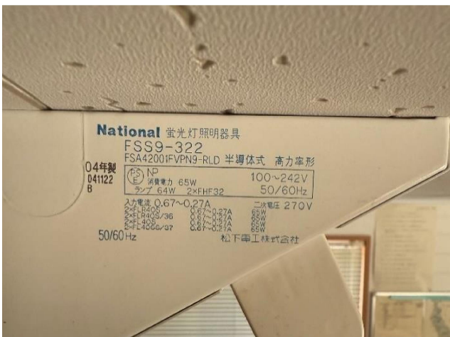
事務所事務室灯
