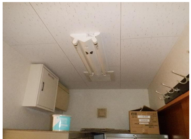
事務所更衣室灯
