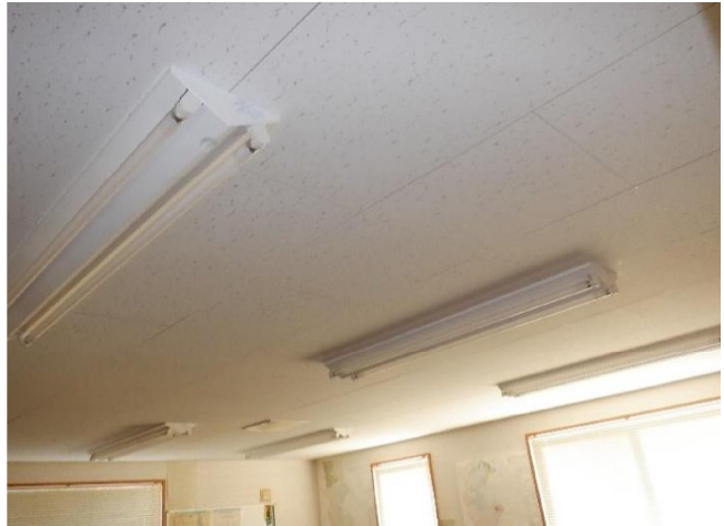
事務所事務室灯
