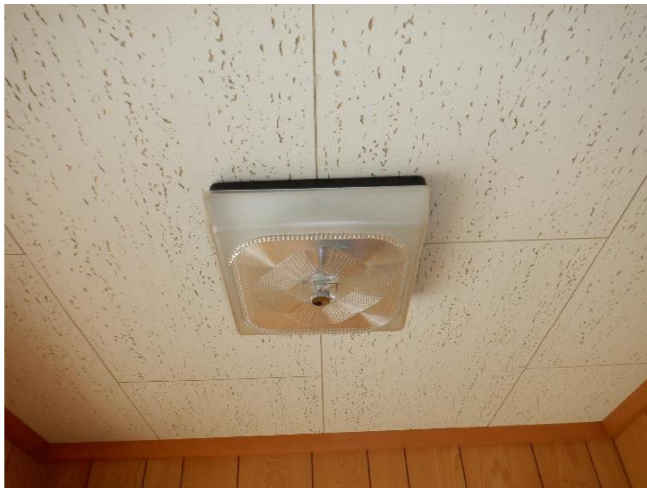
休憩所玄関灯①
