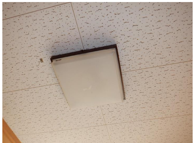
休憩所玄関灯②
