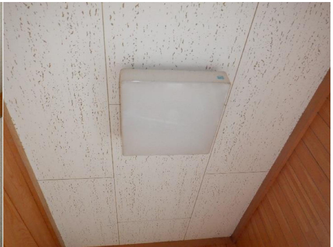
事務所玄関灯
