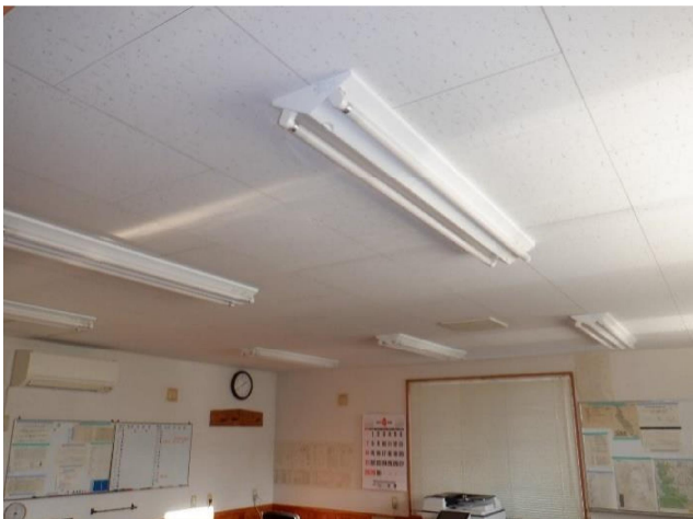
事務所事務室灯
