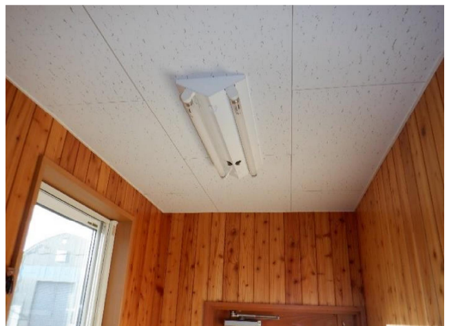
事務所玄関灯
