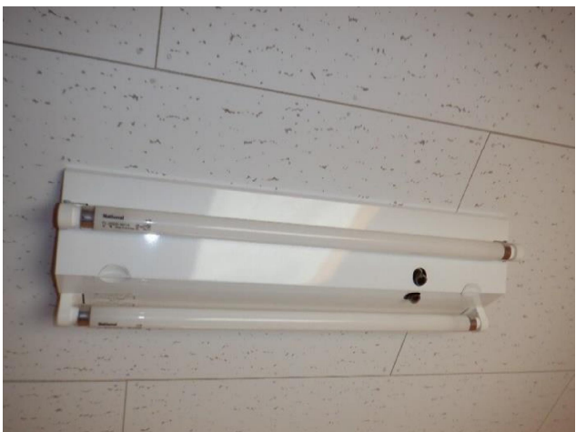
事務所玄関灯
