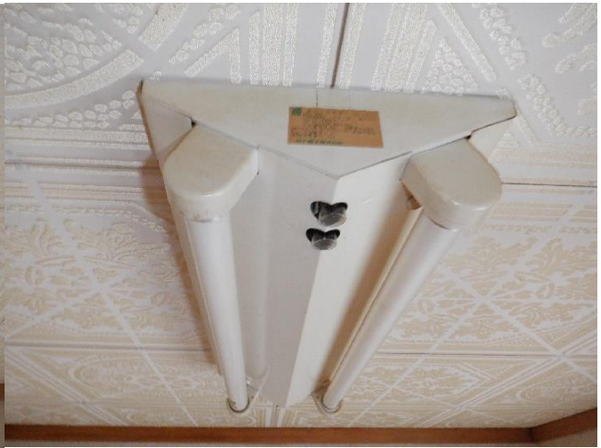
事務所玄関灯
