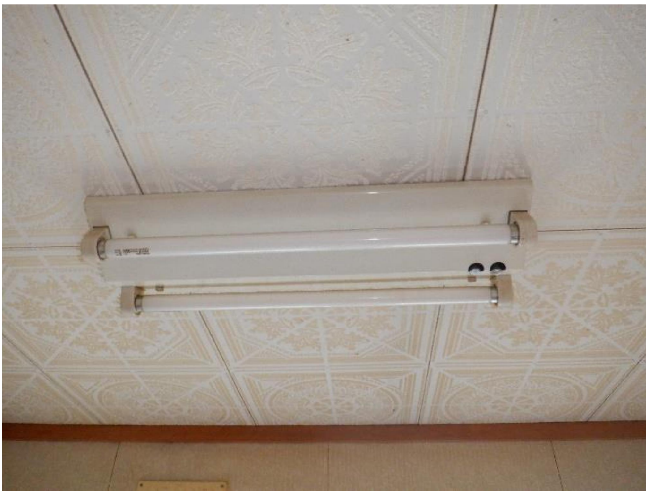
事務室給湯灯
