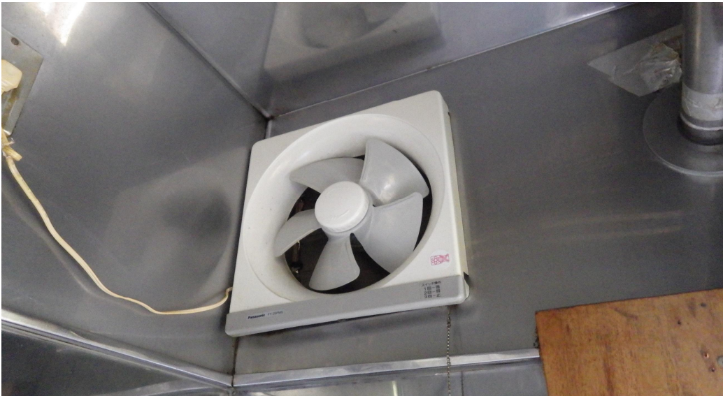
202号室 台所用換気扇
