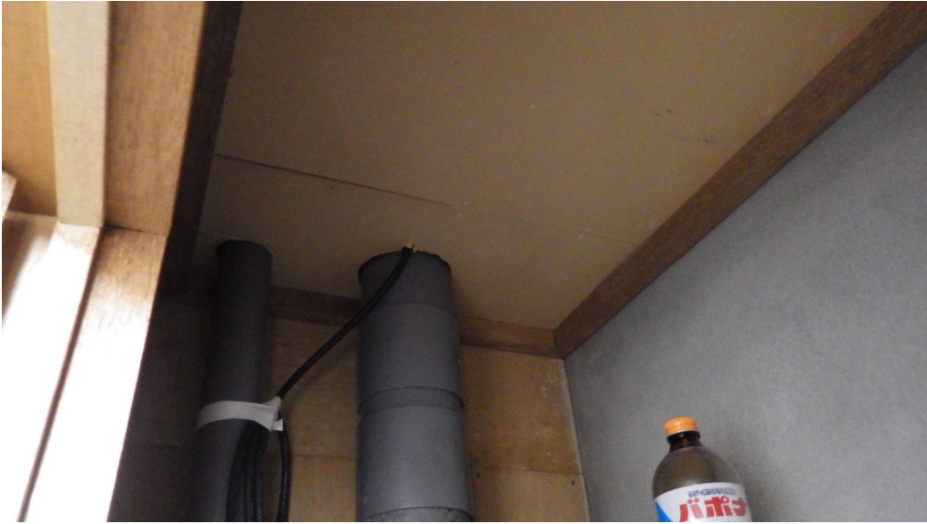
202号室 トイレ臭気ファン
