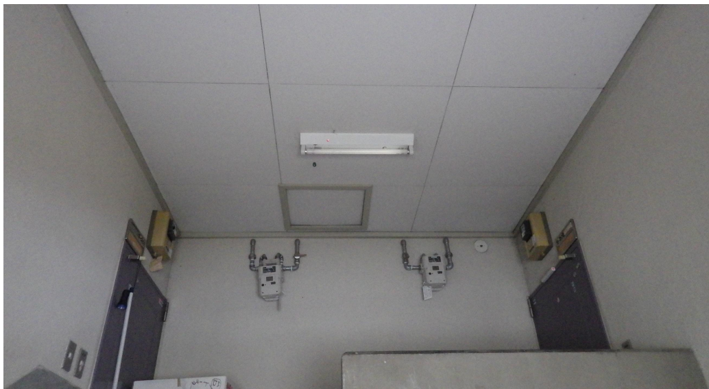
2階共用部 照明器具
