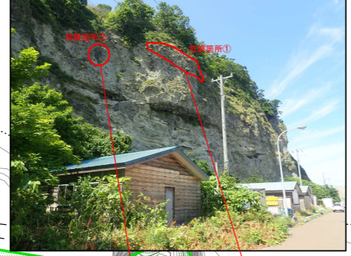
斜面状況① [II工区] 危険箇所① 幅 9.0m, 斜長 8.0m 危険箇所②(浮石) 幅 1.5m, 高さ 1.8m, 奥行き 1.2m
