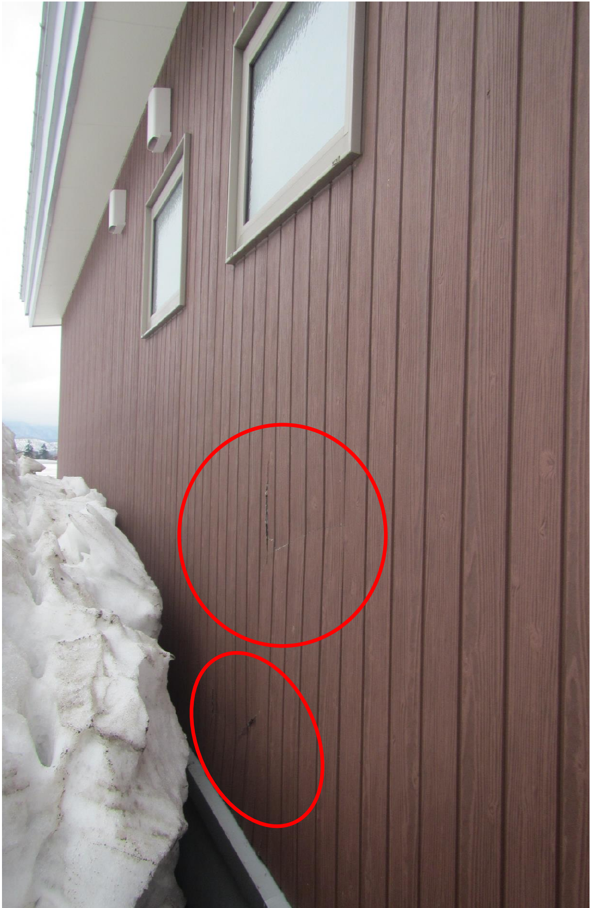
銀山森林事務所外壁損傷部
