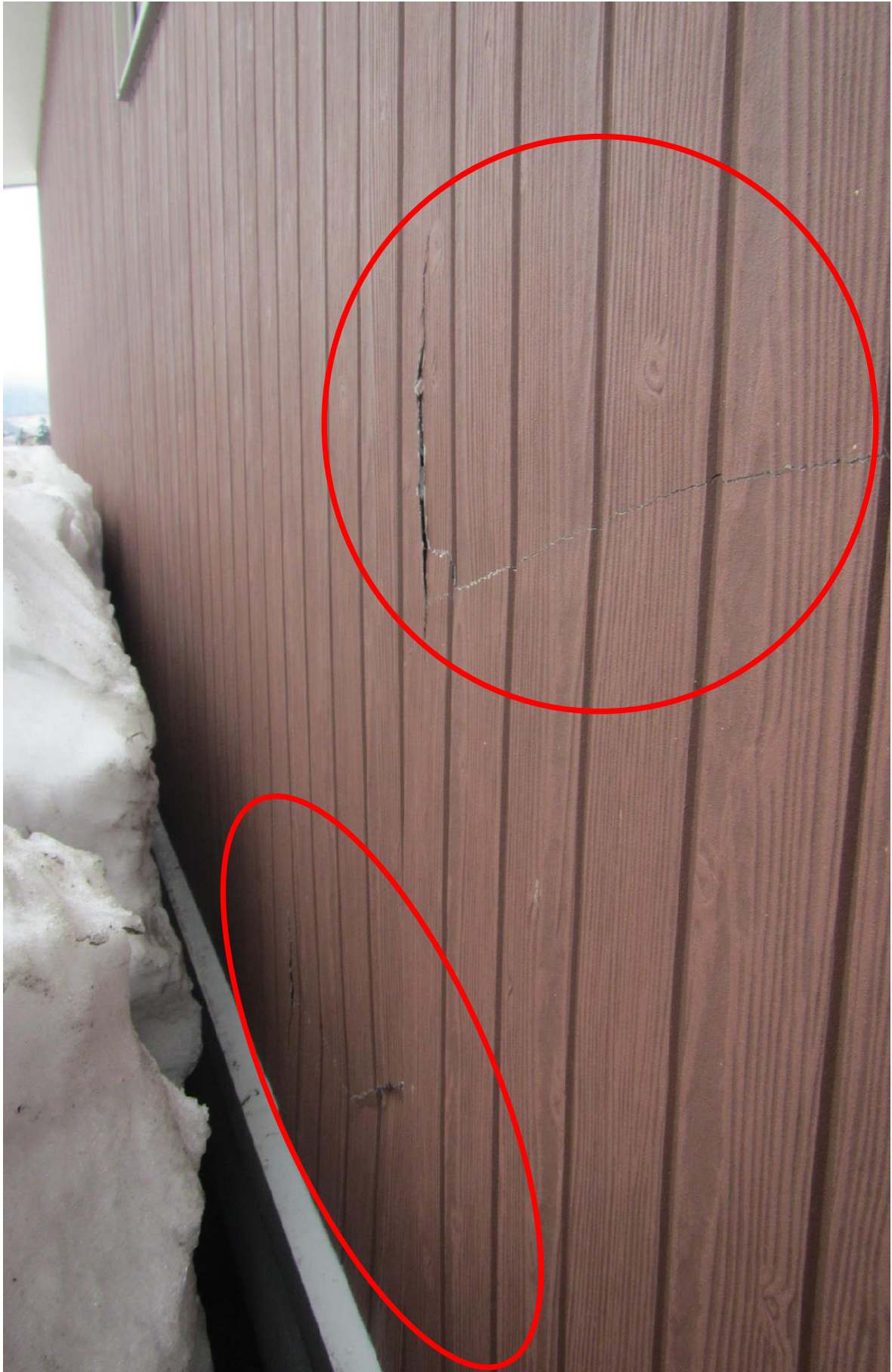
銀山森林事務所外壁損傷部
