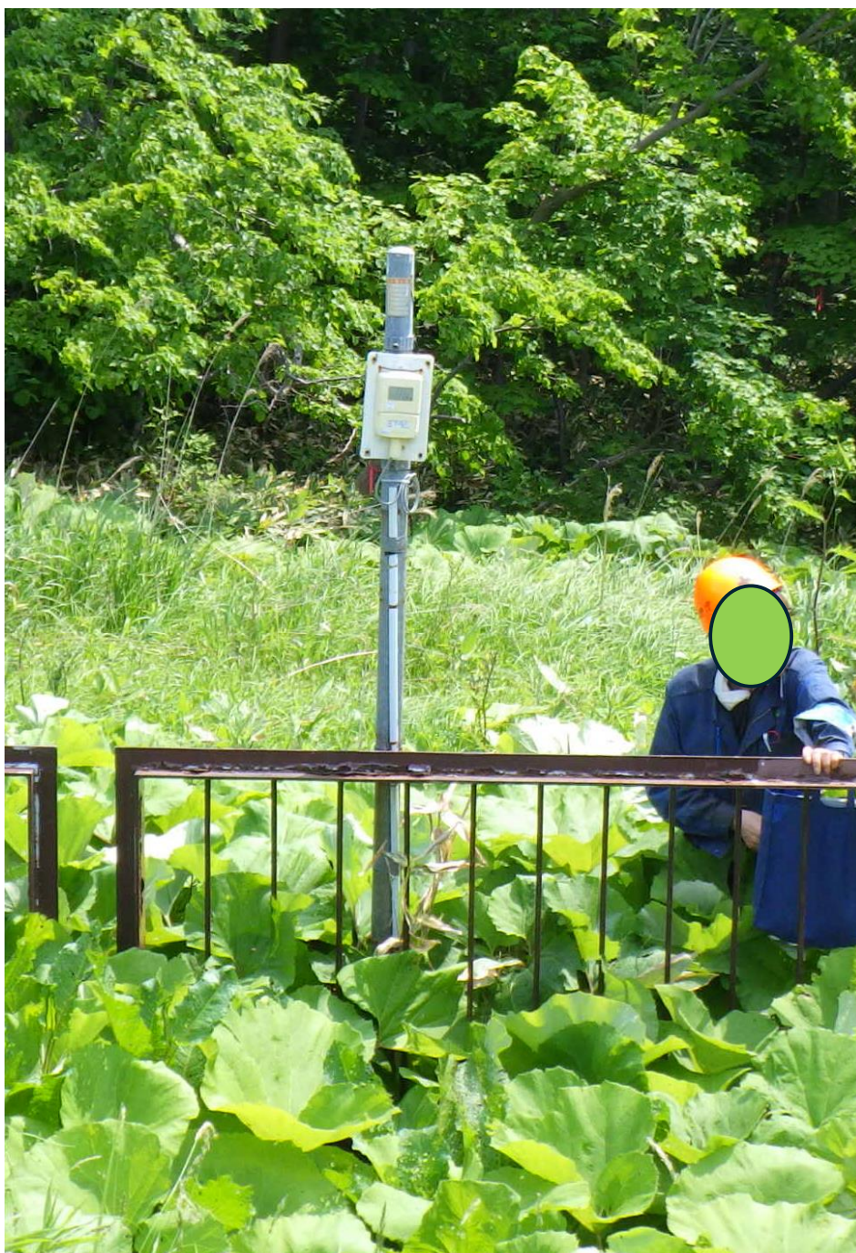
既設メーター
