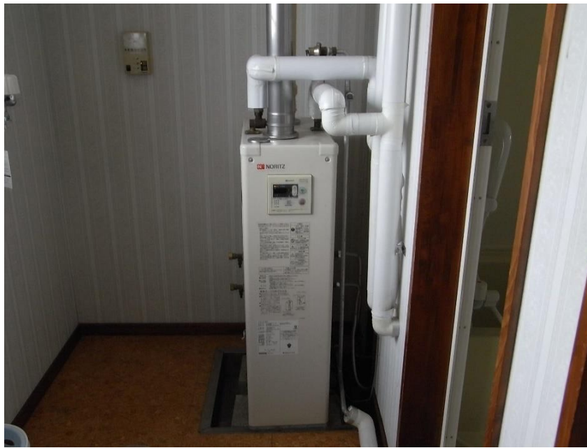
②脱衣所（給湯器設置個所：壁）
