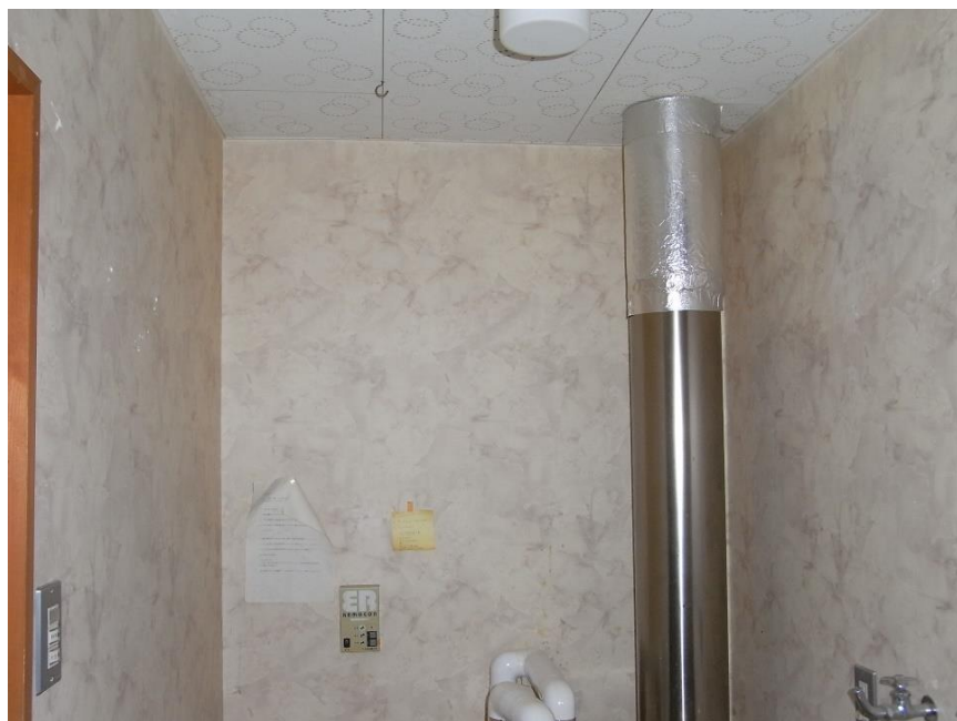
③脱衣所（給湯器設置個所：天井）
